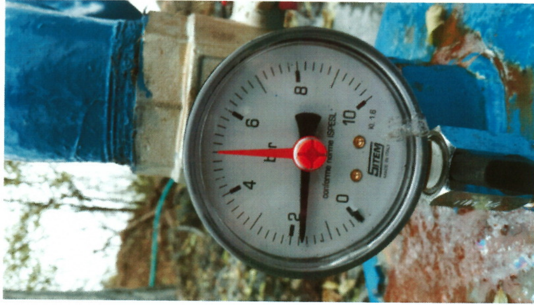
Tlak na ústí vrtu
